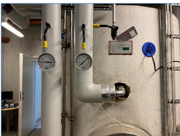
Foto 5: Reguleringsventiler i kælder
