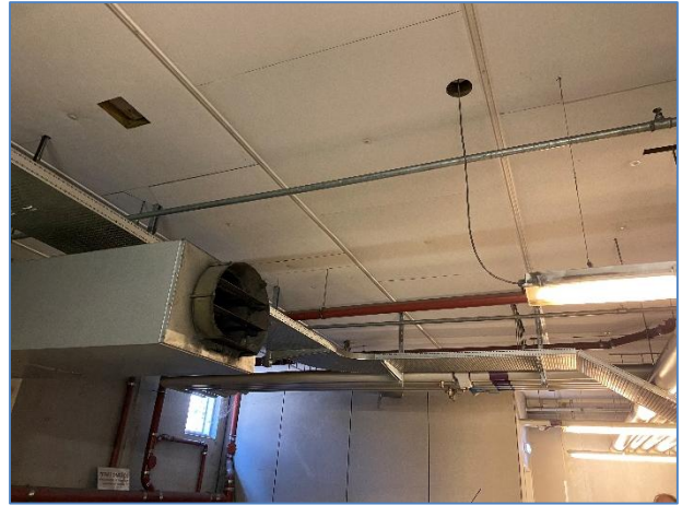
Foto 2: Ventilering af kælder
