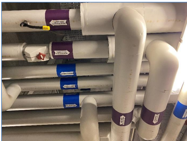
Foto 1: Fordelingsledninger i kælder
