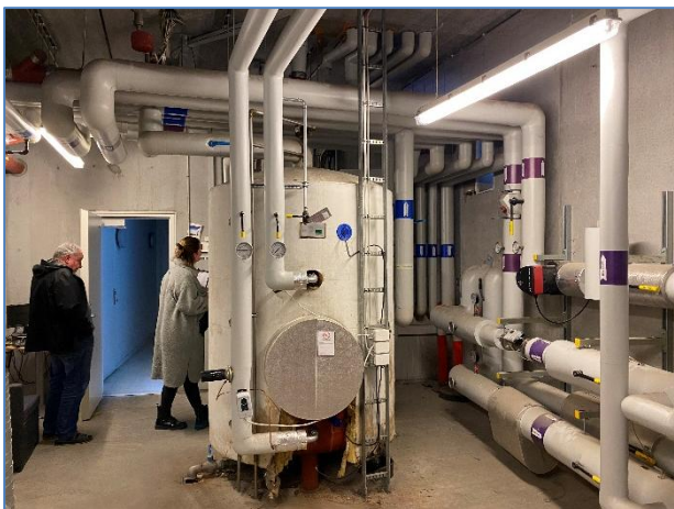
Foto 1: Varmecentral i sin helhed
